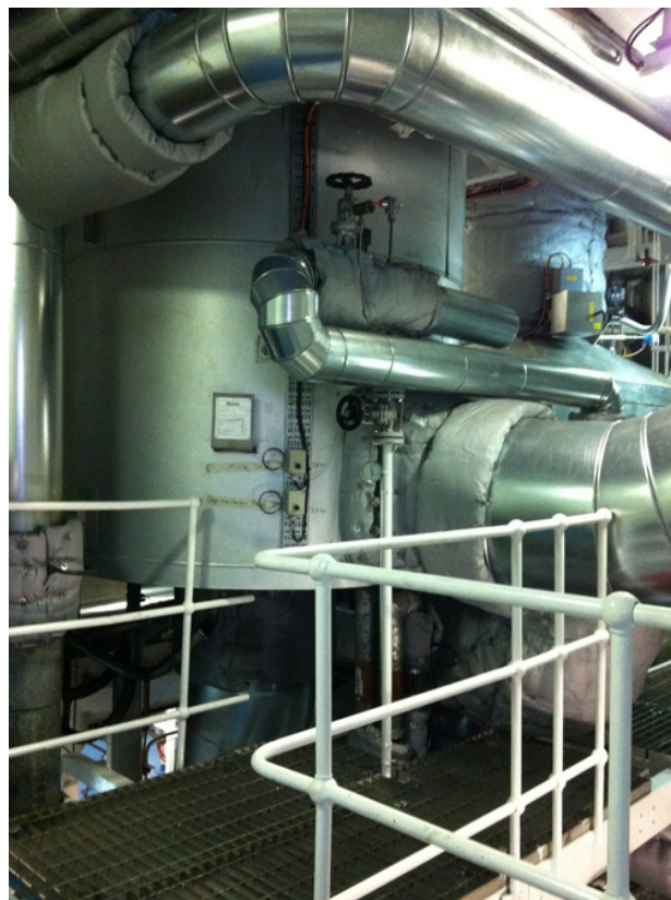
Figur 3 GESAB Catamiser i maskinrommet på «Ternvag»
